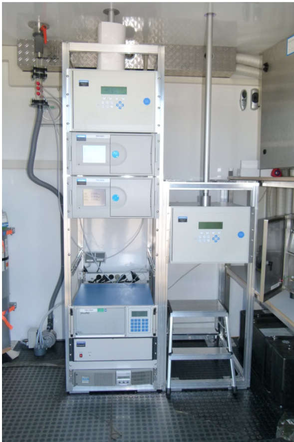
Abbildung 9. Innenausstattung der mobilen Luftgütemessstation.
