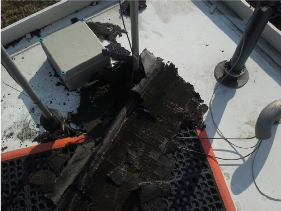
Abbildung 16. Sturmschäden der mobilen LGM (Pulling) – Bild 1 (09.04.2015).
